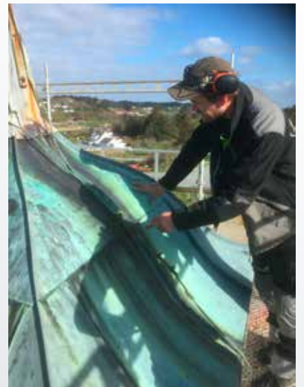
Kopperen på tårntaket inspiseres. Flere steder er det tæret hull i metallet.
